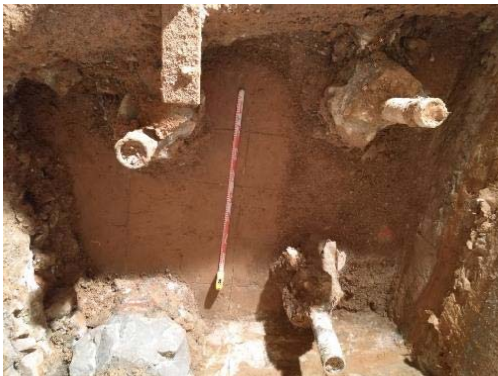
Foto 14: Encepat 3. Paviment UE 4
