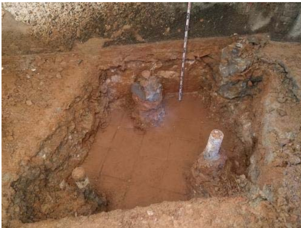
Foto 17: Encepat 4. Paviment UE 4
