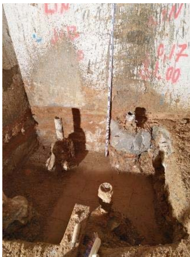
Foto 12: Encepat 3. Paviment UE 4
